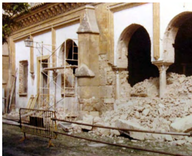
Figura 15. Córdoba. Mezquita-Catedral. Proceso de demolición del cerramiento de la galería norte del patio. 1982 (Herrero, 2015a: 227).
