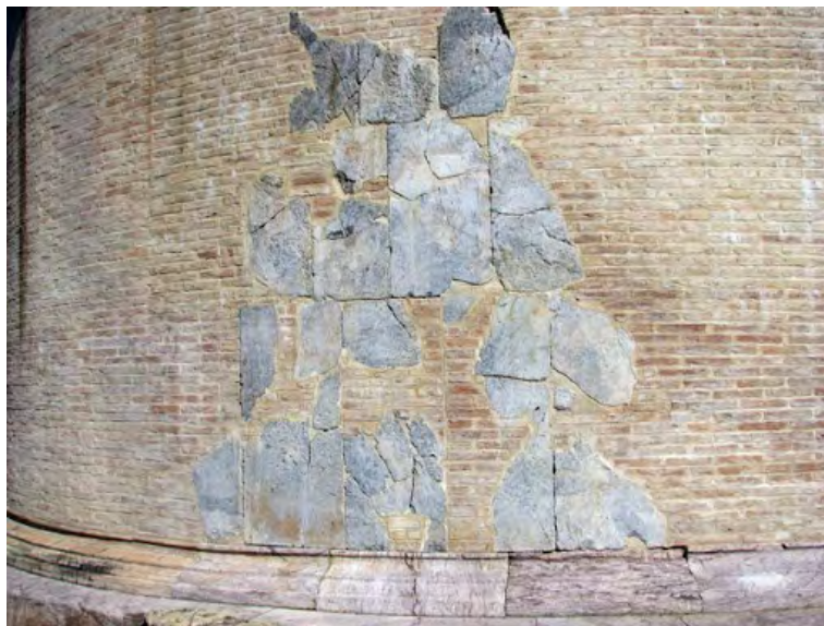
Figura 34. Córdoba. Mausoleo norte de Puerta Gallegos. Restos del revestimiento marmóreo reintegrados en la reconstrucción. Obsérvese el dominio abrumador del ladrillo frente a los elementos originales. Fuente: http://notascordobesas.blogspot.com/2011/06/monumentos-funerarios-de-la-puerta-de.html .
