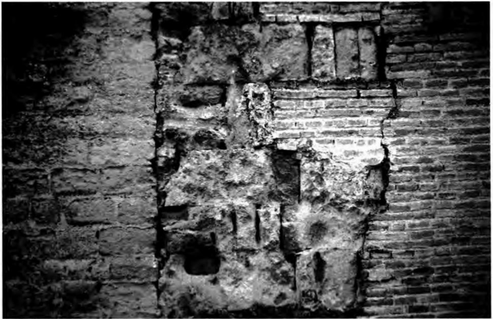
Lámina 8: Aparejo califal de la torre-puerta primitiva dispuesto sobre el trasdós del arco: a. Vista general en la que se aprecia una alternancia regular de una soga por tres tizones. b. Detalle del anterior.
