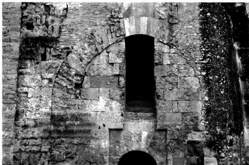
Lámina 4: Detalle del arco, cegado y reparado en época moderna con diversas fábricas.
