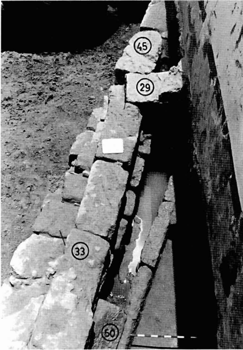
Lám. VI: Otro momento de la excavación de la cloaca de Ronda de Isasa, 4-97, una vez levantadas las losas de la cubierta
