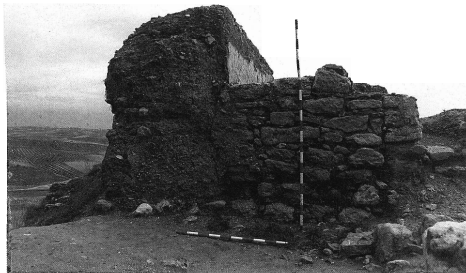
Lám. 2.- Cara interior del muro de tapial n.º I, al que se adosa la torre n.º IV, que flanquea por el Norte la entrada en recodo.
