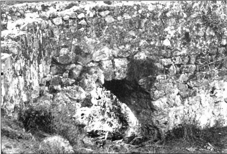
Lám. 8. Puente sobre el río Guadalnuño (camino del Pretorio). Primer arco de la margen derecha.
