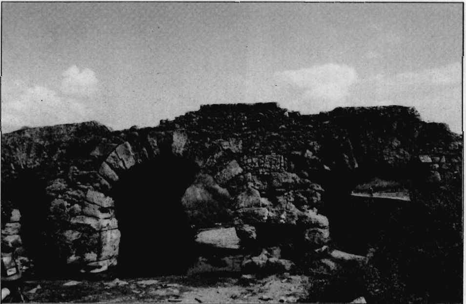
Lám. 4. (Puente n.17) Vista del puente aguas arriba; obsérvese la diversa factura de cada uno de los arcos.
