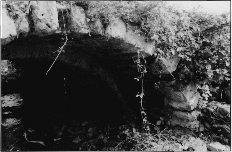
Lám. 10. (Puente n.23) Vista del arco aguas abajo; obsérvese el recrecido adosado al arco originario.
