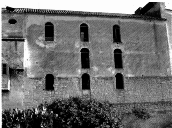
LÁM. IV: Detalle del Molino de Carbonell. En la base pueden apreciarse paramentos pétreos pertenecientes a diferentes periodos, la mayoría medievales.
