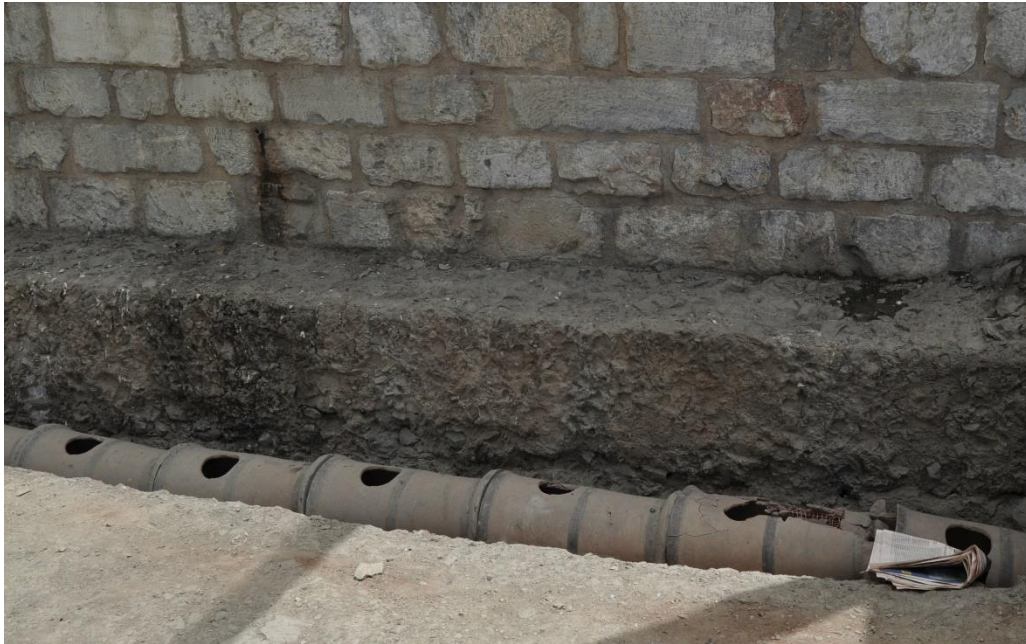
Fig. 11: Situación de deterioro actual del sistema de canalización de época de Pisistrates en la Plaza Sintagma. (Elaboración propia).
