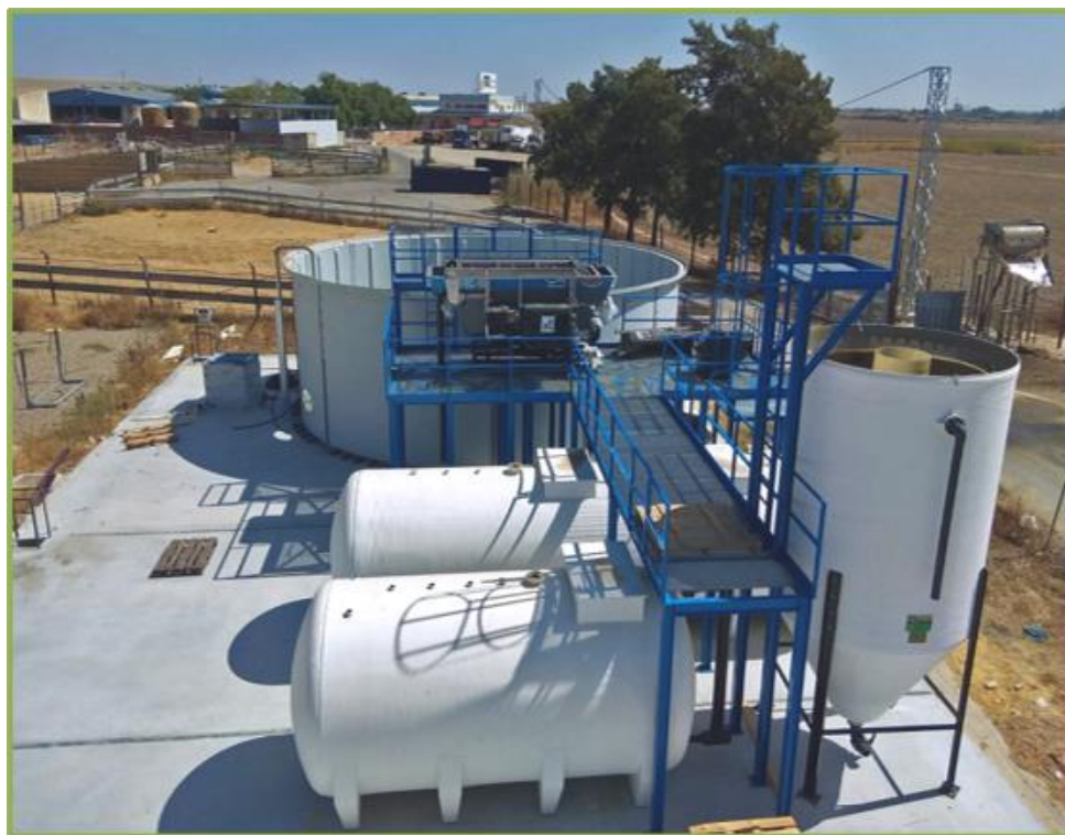
Figura 3. Water2Return SBR instalado en Matadero del Sur, Salteras (Sevilla)
