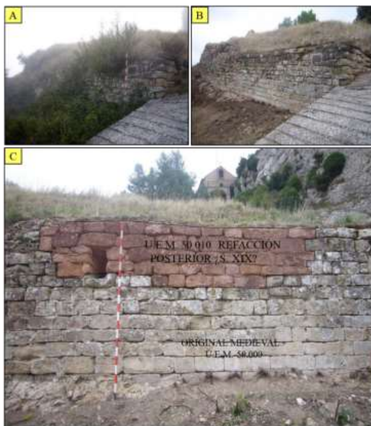
Fig. 5. A) Estado inicial (5/VIII/2015); B) estado final del lienzo exterior de la muralla; C) Detalle de la refacción posterior de la muralla U.E.M. 50.010 (¿siglo XIX?).
