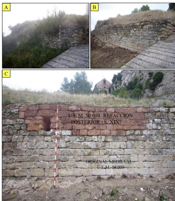
Fig. 5. A) Estado inicial (5/VIII/2015); B) estado final del lienzo exterior de la muralla; C) Detalle de la refacción posterior de la muralla U.E.M. 50.010 (¿siglo XIX?).
