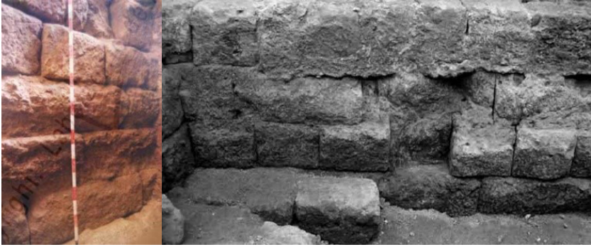
Fig. 4 - Blocs ayant souvent d'érosion dans la fondation de Puerta de Almodóvar (à gauche) (MORENO et al. , 2004, lám. 31) et courtine principale à Ronda de los Tejares n° 11 (à droite) (MOLINA, VALDIVIESO, 2007, p. 40 fig. 6).
