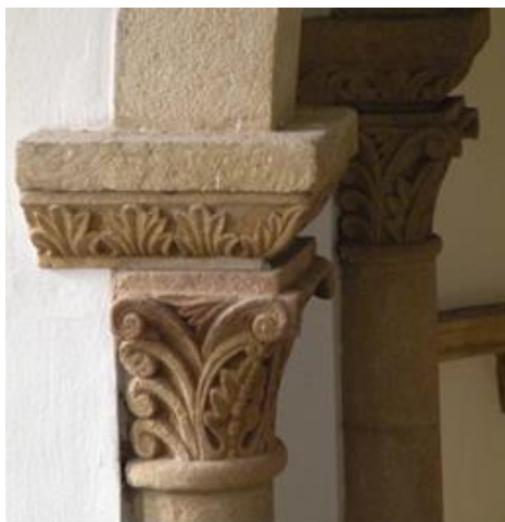
Fig. 11. Casa de Ejercicios Espirituales. Capilla. Detalle de los capiteles. Foto del autor.
